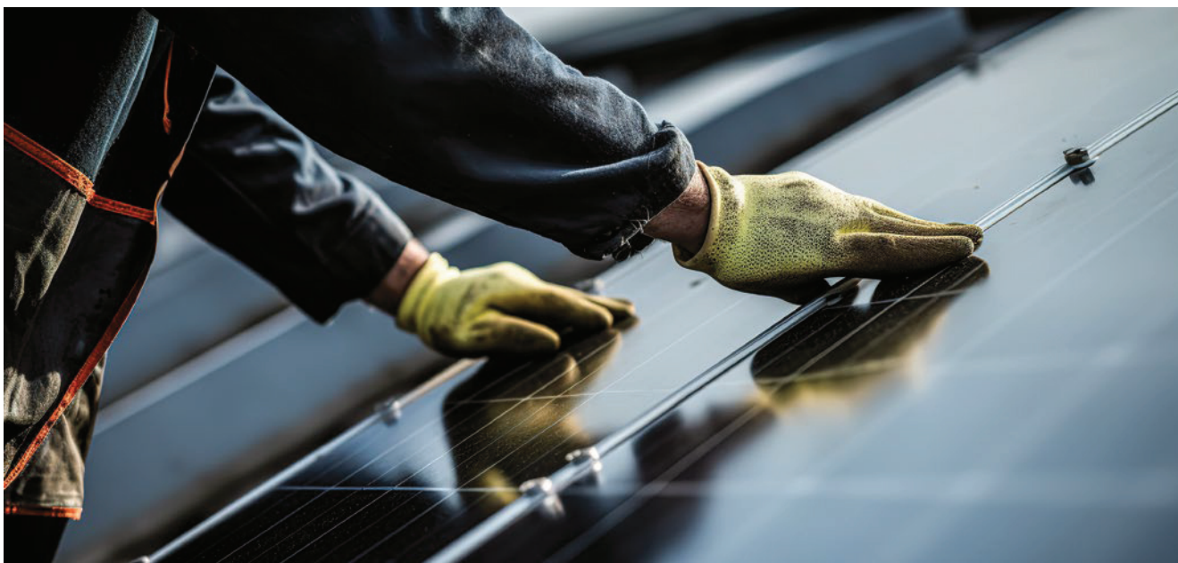
2 | Normgerechte Planung und Installation sind das A und O in Sachen Brandschutz bei PV-Anlagen. Häufigen Risikoquellen wie DC-Stecker, Leitungen und potenziell fehlerhafte Komponenten muss dabei besonderes Augenmerk gelten.
